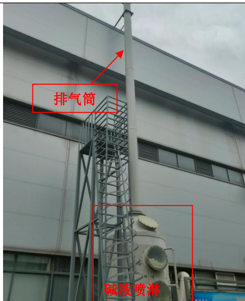
碱液喷淋+15m 排气筒
