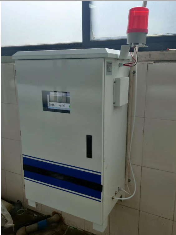
有机废气排气筒在线监测装置
