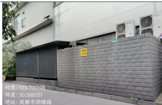
1#悬浮废水处理系统
