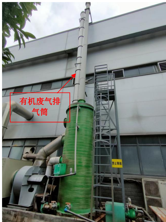
有机废气 15m 排气筒
