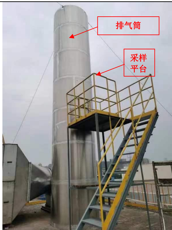
有机废气 15m 排气筒
