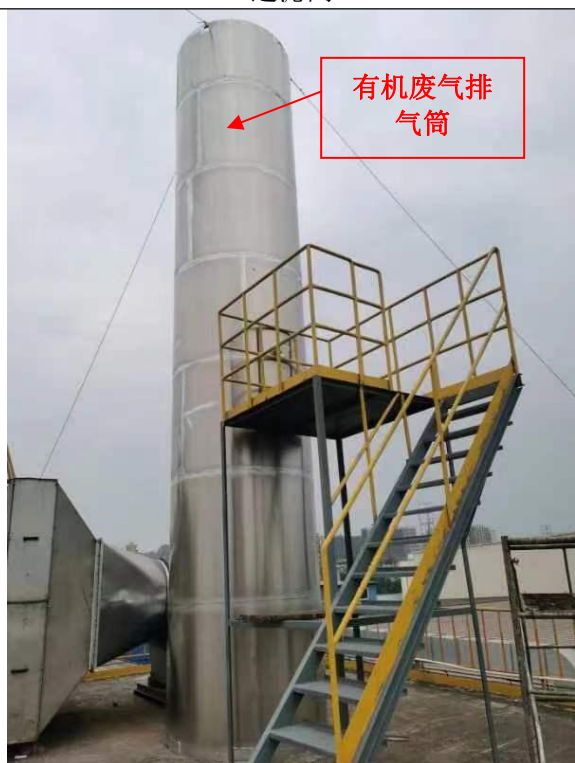
有机废气 15m 排气筒
